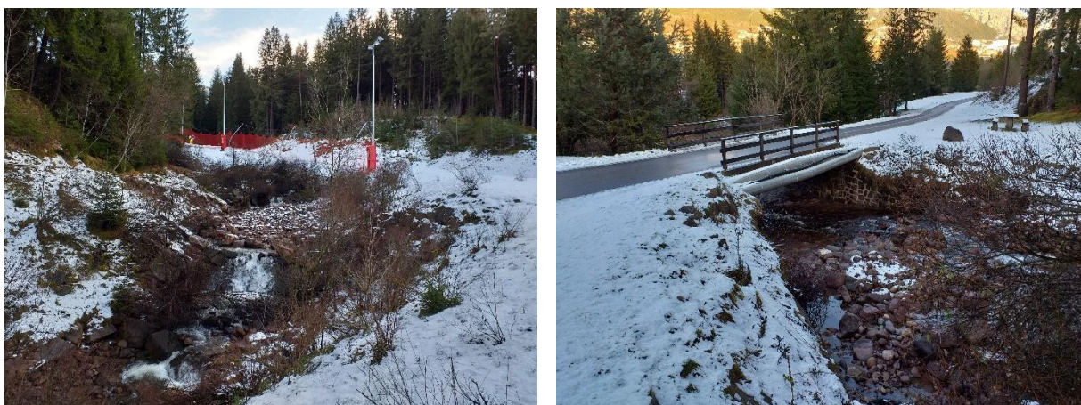
Figura 22: Rio Val della Roda – Immagini al punto 5: Nell’ultimo tratto del corso d’acqua si riconoscono ancora delle zone di deposito di materiale solido in alveo.
